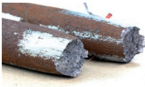
Die dünneren Stäbe wiesen im Versagensbereich eine sehr fein strukturierte Bruchfläche und eine deutliche Brucheinschnürung auf. | The thinner bars showed a very finely structured fracture surface and a clear necking in the failure area. | Photo: Silke Scheerer
