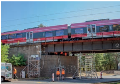
Sensorapplizierung an der Eisenbahnüberführung Veltener Str. (Hennigsdorf) | Sensor application on the Railway Bridge Veltener Str. (Hennigsdorf) | Photo: Stefan Gröschel
