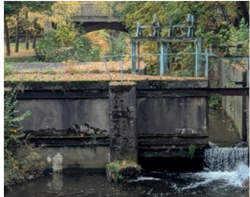
Schäden an einer wasserwirtschaftlichen Anlage | Foto: Kerstin Speck
