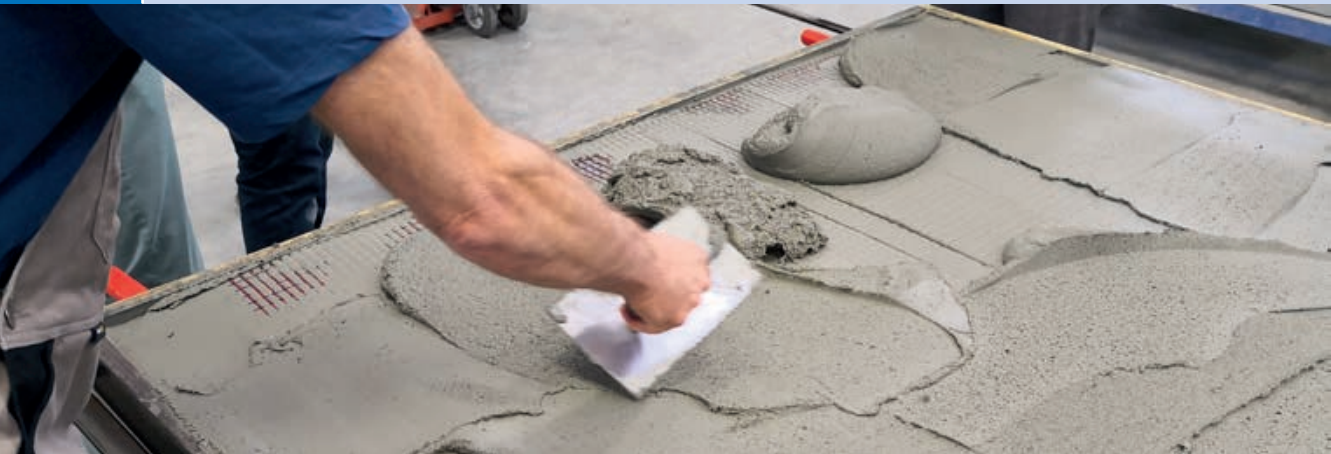
Verstärkungsarbeiten einer Stahlbetonplatte für einen Impaktversuch | Strengthening of a reinforced concrete slab for an impact test | Photo: Stefan Gröschel
