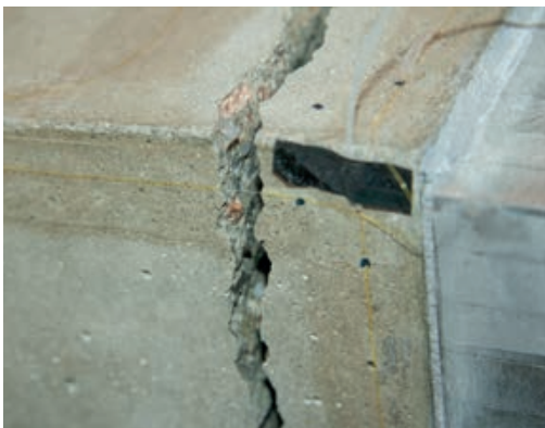
Dehnungsmessung mit faseroptischen Sensoren auf der Betonoberfläche | Strain measurement with fibre optic sensors on the concrete surface | Photo: Kerstin Speck
