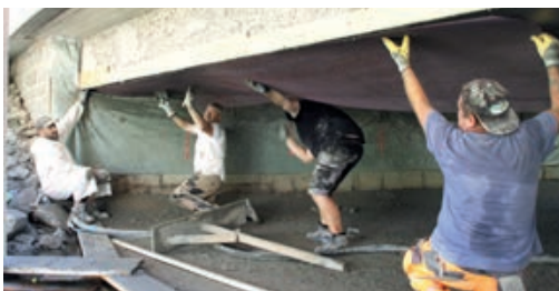
Verstärkungsarbeiten mit Carbonbeton an der Brückenunterseite | Strengthening with carbon reinforced concrete at the bottom of the superstructure | Photo: Oliver Steinbock
