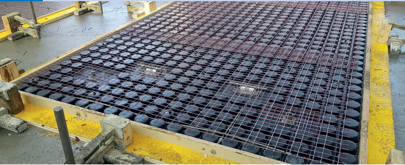
Eine Kunststoffmatrize garantiert die Lagesicherheit der textilen Bewehrung sowie der Funktionskomponenten. Sie wird auf die Schalung gelegt und ausbetoniert. | A plastic matrix guarantees the positional stability of the textile reinforcement and the functional components during concreting in the precast plant. | Photo: Dominik Schlüter
