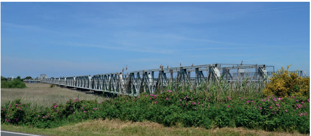
Die seit 2012 für den Verkehr gesperrte Meiningenbrücke | Foto: Raphael Schulz
