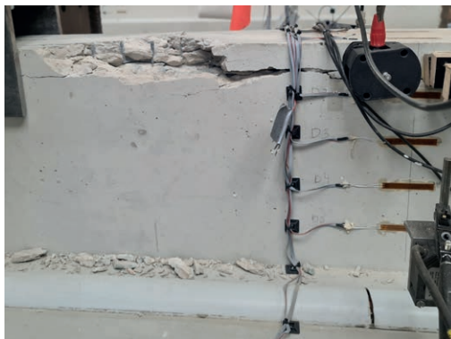
Detailaufnahme eines Ermüdungsschadens | Detailed view of a fatigue damage | Photo: Olaf Menze
