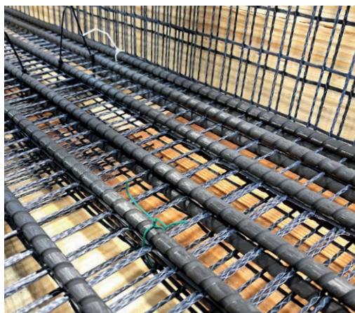
Bewehrungskorb aus Carbonfaserstäben in der Schalung | Carbon reinforcement cage in the mould | Photo: Oliver Steinbock
