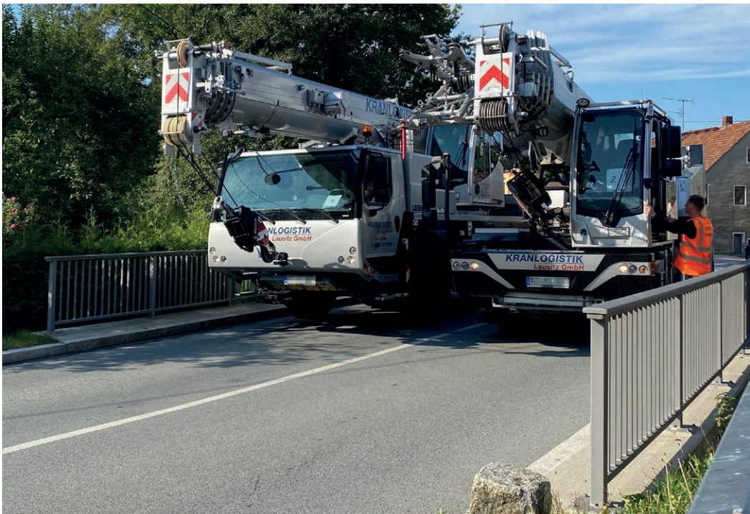
Probebelastung einer mit Carbonbeton verstärkten Brücke durch zwei Mobilkrane | In situ loading of a bridge strengthened with carbon reinforced concrete by two mobile cranes | Photo: Josiane Giese
