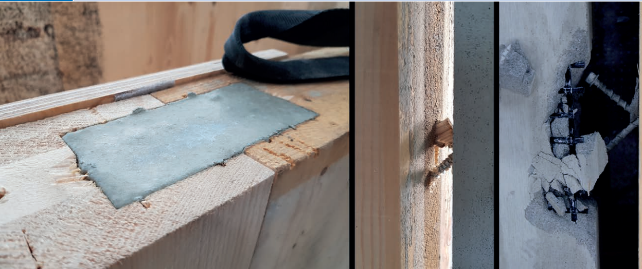
Verbindung von Brettsperrholzwandscheiben mit innenliegender Betonnut (links), Versagen der Schraubenverbindung (Mitte), Ausbruch des Carbonbetons (rechts) | Connection of cross-laminated timber wall panels with internal concrete groove (left), failure of bolted joint (centre), the breakout of carbon concrete (right) | Photos: Ludwig Hahn, Auerbach und Hahn GmbH
