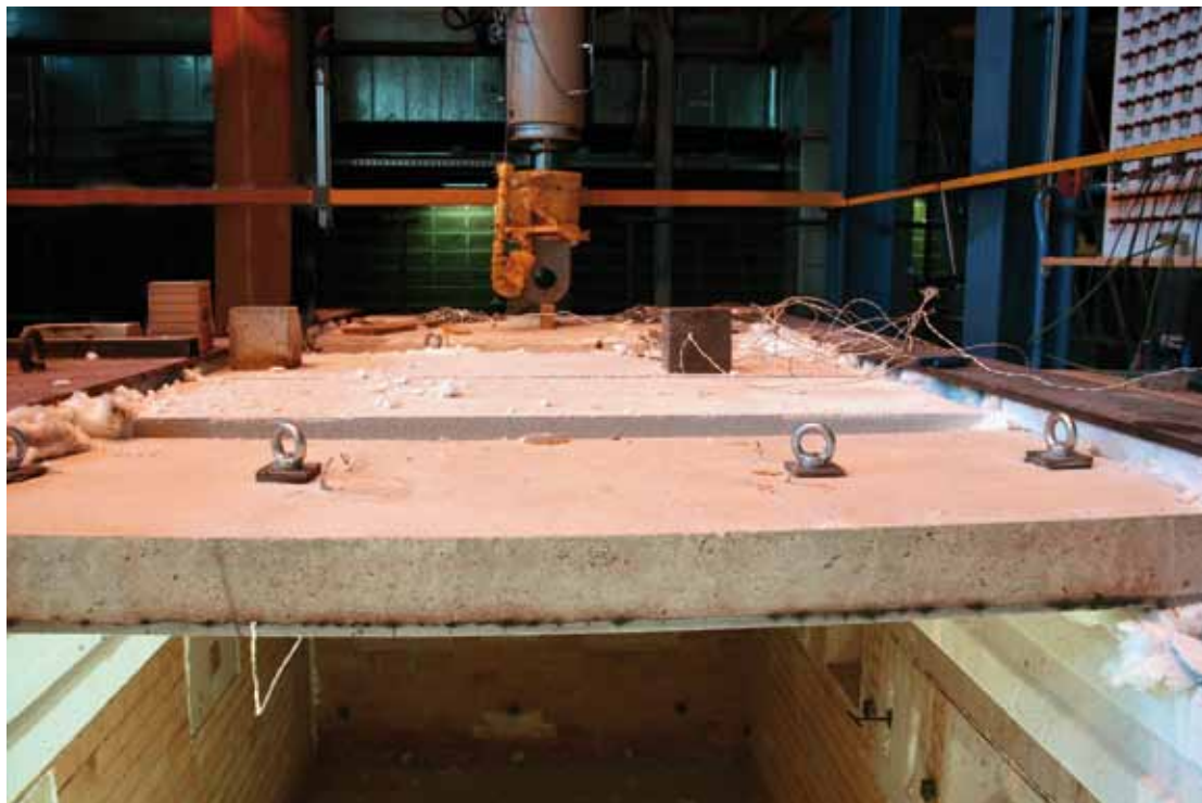
Textilbetonverstärkte Stahlbetonplatte nach dem Brandversuch
