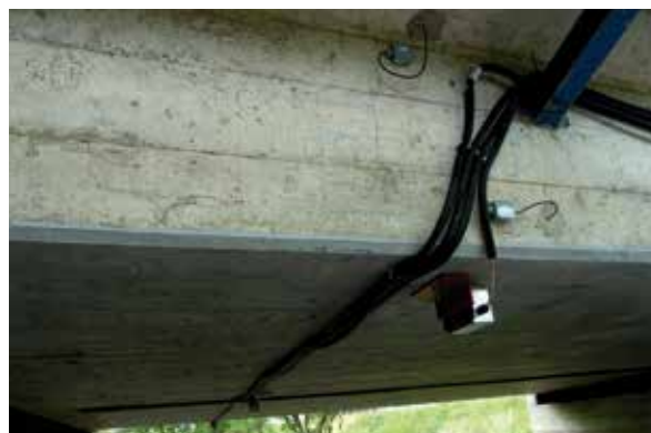
Bild 25: Permanentes Brückenmonitoring bei der Kocherbrücke Untergröningen (Foto: J. Buchmann, BBV)
