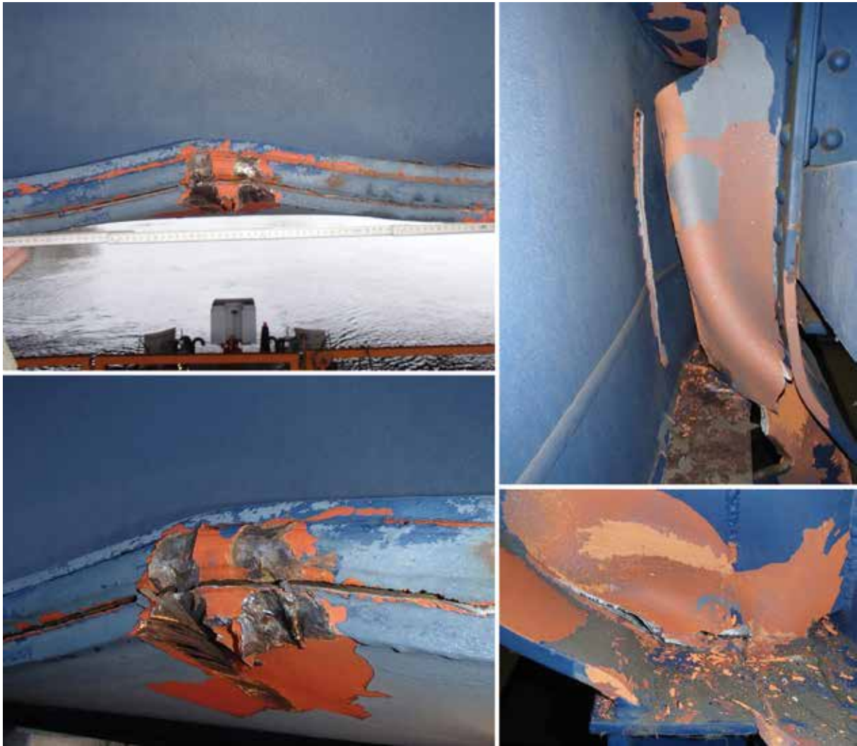
Bild 4: Schäden an Flansch und Aussteifungselementen
