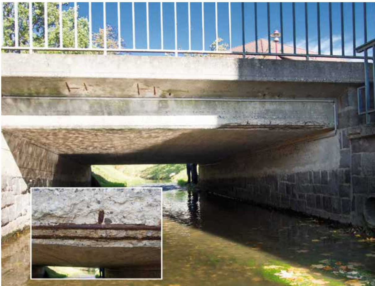
Bild 11: Brücke Bretnig (LISt) mit Detail korrodierte Bewehrung
