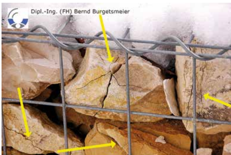
Bild 15: Frostschaden an ungeeignetem Füllmaterial eines Steinkorbes [32]
