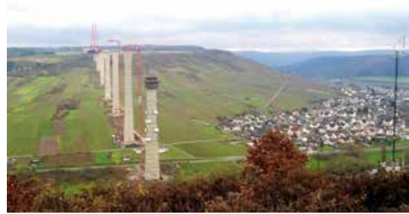
Bild 4: Blick auf die Baustelle vom linken Moselufer, Stand November 2015 (© Hünnebeck Deutschland GmbH, Ratingen)
