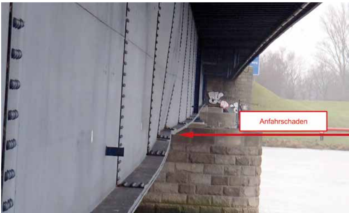
Bild 5: Anfahrtschaden, Ansicht aus Süden
