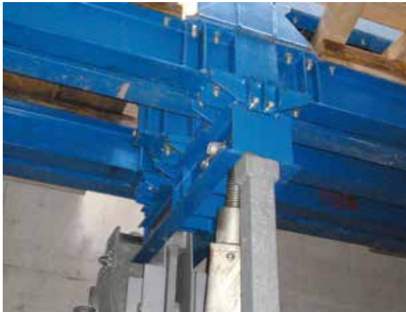
Bild 17: Drehlager unter Innenbühne (© Hünnebeck Deutschland GmbH, Ratingen)
