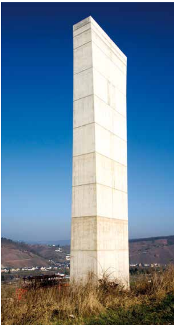
Bild 8: Oberflächenqualität des Betons (© Hünnebeck Deutschland GmbH, Ratingen)
