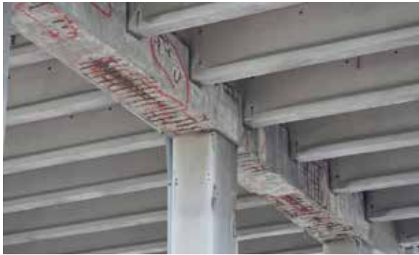
Bild 6: Hochstraße Inzersdorf in Wien – Schadensbild an einem Querträger (Foto: Sebastian Wilhelm)
