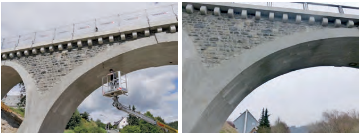
Bild 8 Durchfeuchtung mit Riss und Aussinterung am Bogen 3 vor (links) und nach (rechts) der Austrocknung Fotos: Ammar Al-Jamous und Karsten Uhlig
