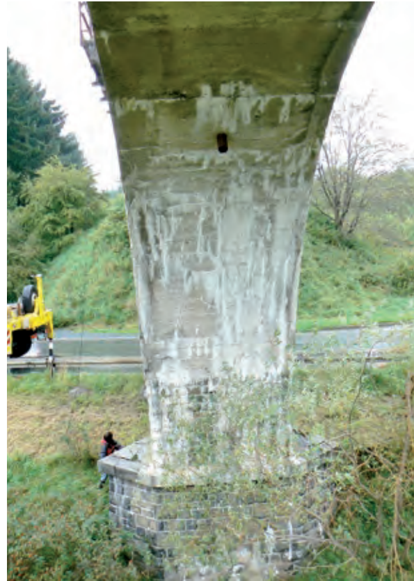
Bild 2 Schadensbild Bogen 2 Foto: Karsten Uhlig
