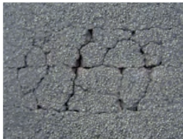
Bild 2 Rissbild im Asphaltbelag Foto: P. de Jong
