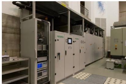
Schaltschrankbatterie zum Prüfstand
