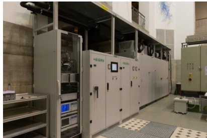
Schaltschrankbatterie zum Prüfstand
