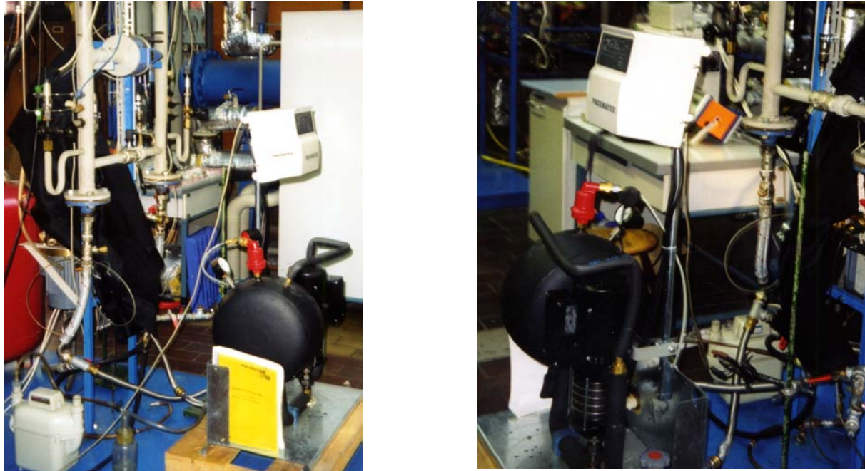
Abbildung 4-12 Einbausituation am Fernwärmeversuchsstand der TU Dresden
