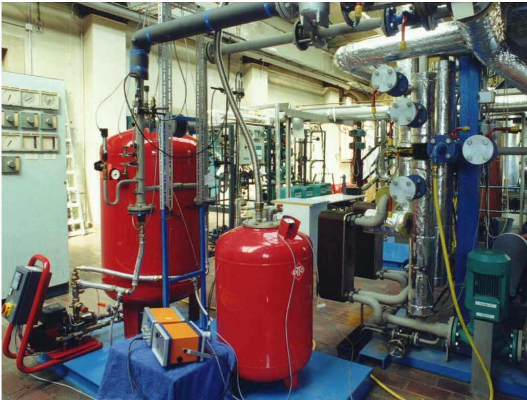
Abbildung 4-5 Aufbau Behältertest am Fernwärme-Versuchsstand
