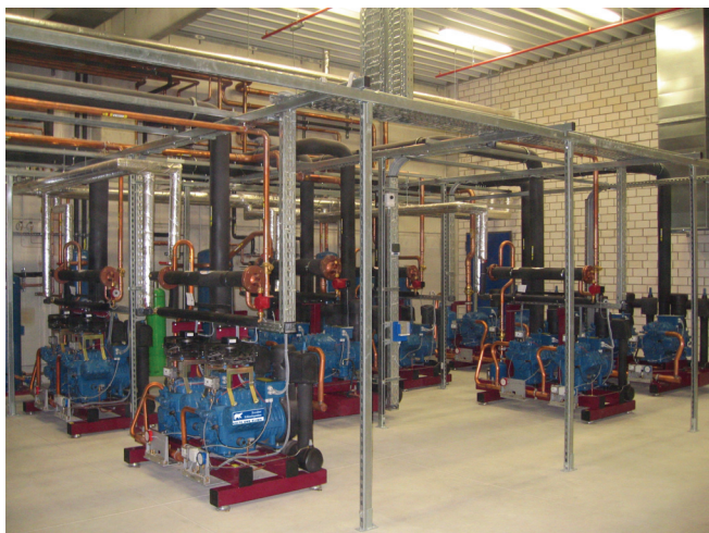
Vom DKA ausgestatteter Maschinenraum eines Logistikzentrums in Wustermark
