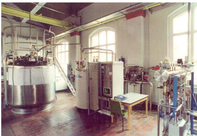
Die Heliumanlage der TU Dresden im ehemaligen Vorführungssaal von Richard Mollier
