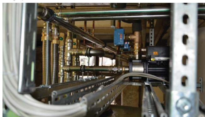
Blick auf die Verteiler- und Pumpengruppe des Pufferspeichers
