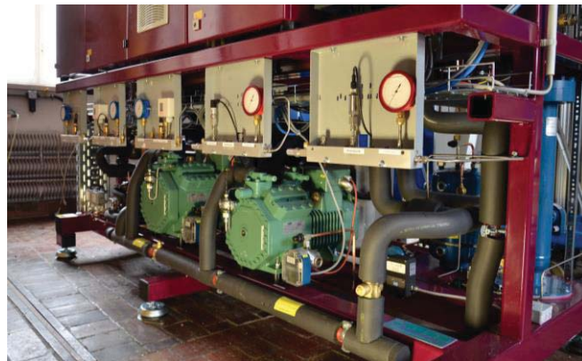
Der Verdichterverbund – Herzstück der neuen Versuchsanlage
