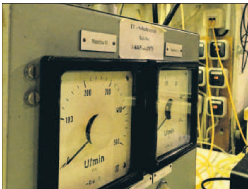
Nicht ganz High-Tech, aber robust und zuverlässig: die Regelungstechnik des Windkanals an der Dresdner Marschnerstraße.
